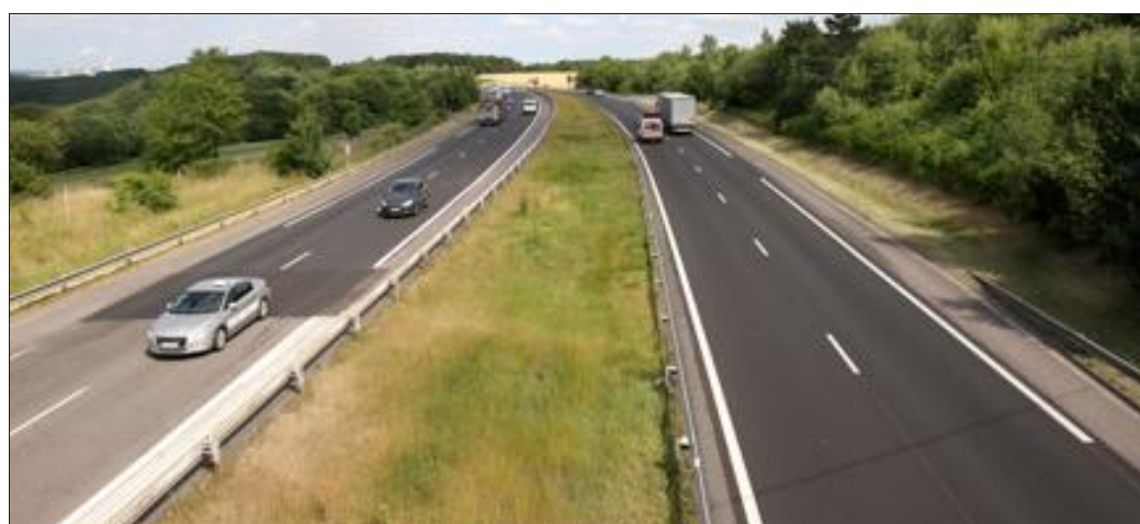
Dernière tranche de travaux entre le péage de Boulay et Saint-Avold, avec basculement de chaussée. Photo Thierry SANCHIS
