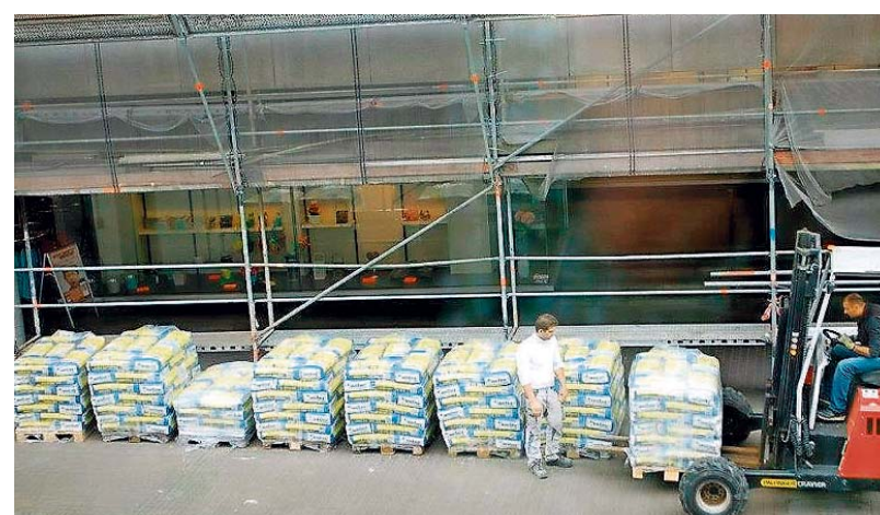
Diese Paletten mit Baumaterial wurden am 20. Mai angeliefert. Während sich an der Fassade nichts tat, wurden gestern Nachmittag Säcke in Richtung Seiteneingang abtransportiert. ARCHIVFOTO: ANGELIKA FERTSCH
