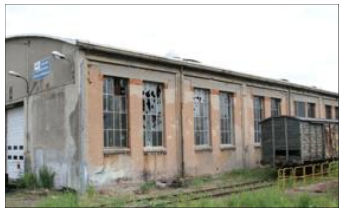
Les fenêtres du bâtiment ferroviaire, ancien atelier de locomotives, ont été brisées. Photo Philippe RIEDINGER
