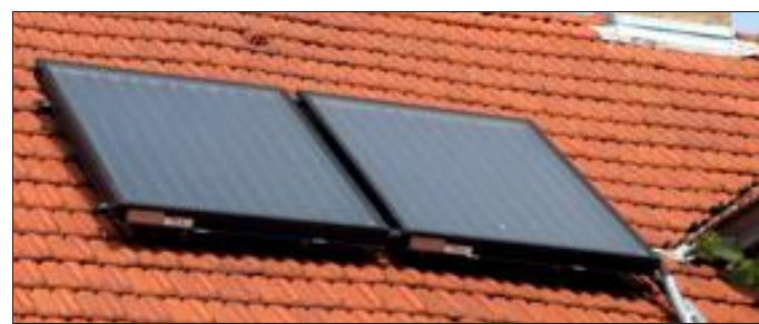
Dès 2013 un cadastre solaire permettra de savoir si une toiture est apte ou pas à recevoir des panneaux. Photo Philippe RIEDINGER
