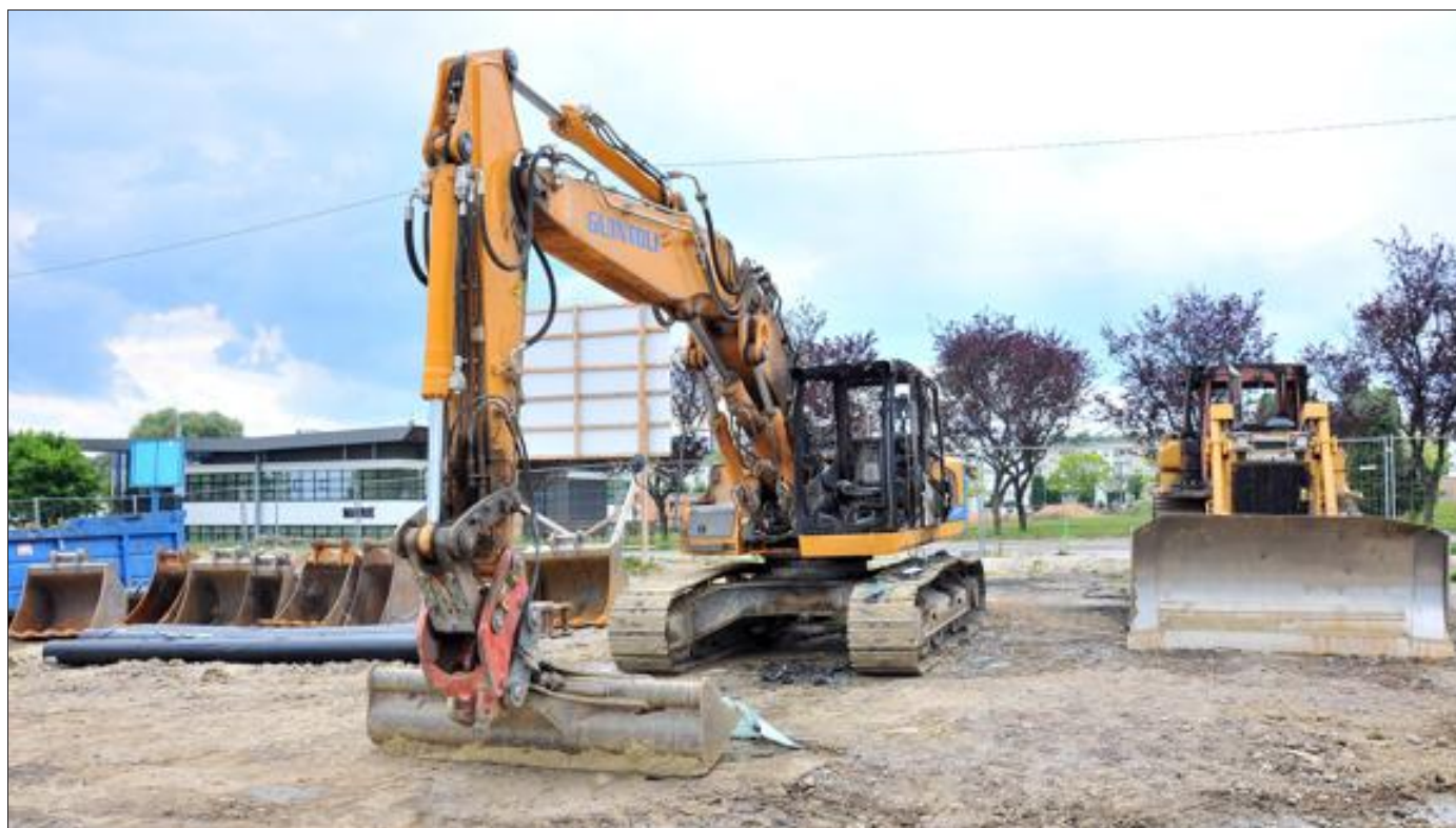
Les premiers éléments de l'enquête laissent penser que la pelleteuse aurait été visée dans un premier temps. Le bulldozer aurait ensuite été endommagé par les flammes du véhicule voisin. Photo Emilie KIEFFER
