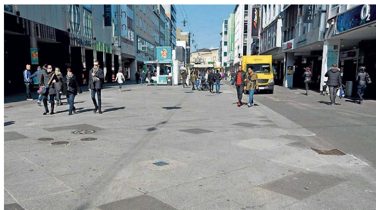
Wie ein Flickenteppich sieht nach 20 Jahren das Pflaster in der Bahnhofstraße aus. In der Mitte werden bald neue Platten und für die Lkw vor den Arkaden Asphalt verlegt. SZ-ARCHIVFOTO: BECKER&BREDEL
