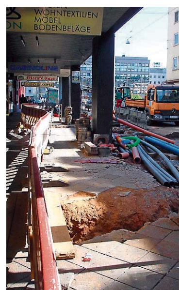
In der Alt-Saarbrücker Eisenbahnstraße wird wohl fast ohne Unterbrechung bis Herbst 2014 gebaut. FOTO: ROLSHAUSEN
