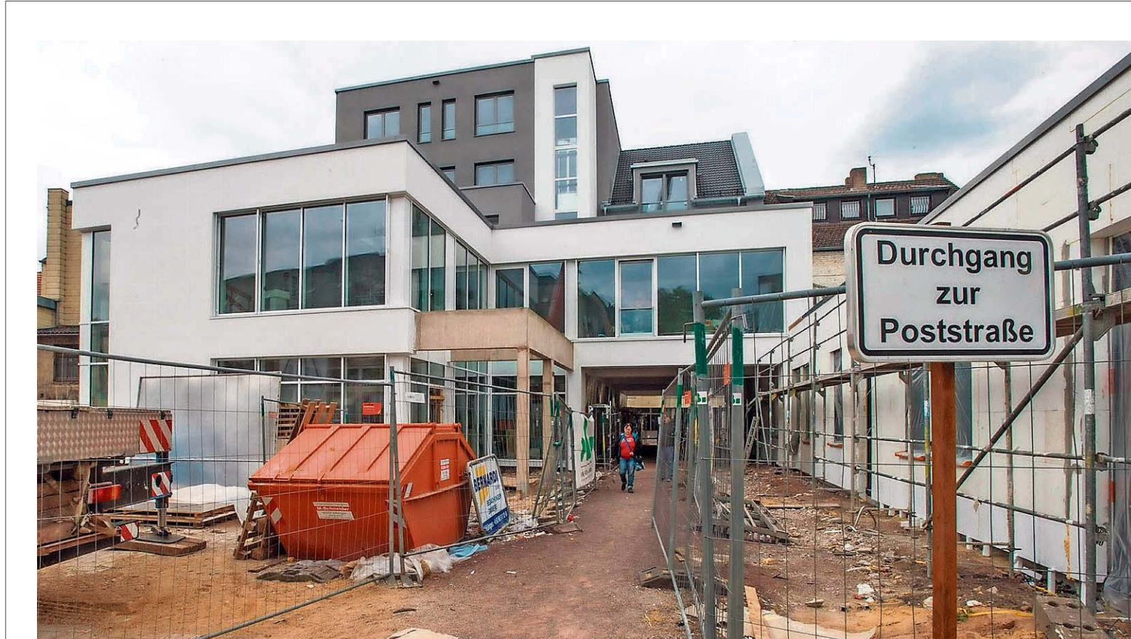
In dem Ärztehaus, hier gesehen von der Fußgängerzone Forbacher Passage aus, läuft bereits der Innenausbau. Erste Mieter können schon bald einziehen, und drei Orthopäden wollen hier im Juli mit ihrer Praxis beginnen.
